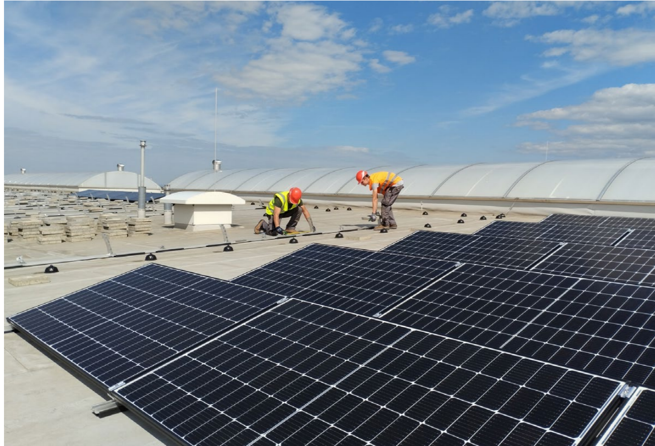
Důležité u plochých střech je nepodcenit statiku a zajistit panely proti odfouknutí. Zdroj: Solar Design
