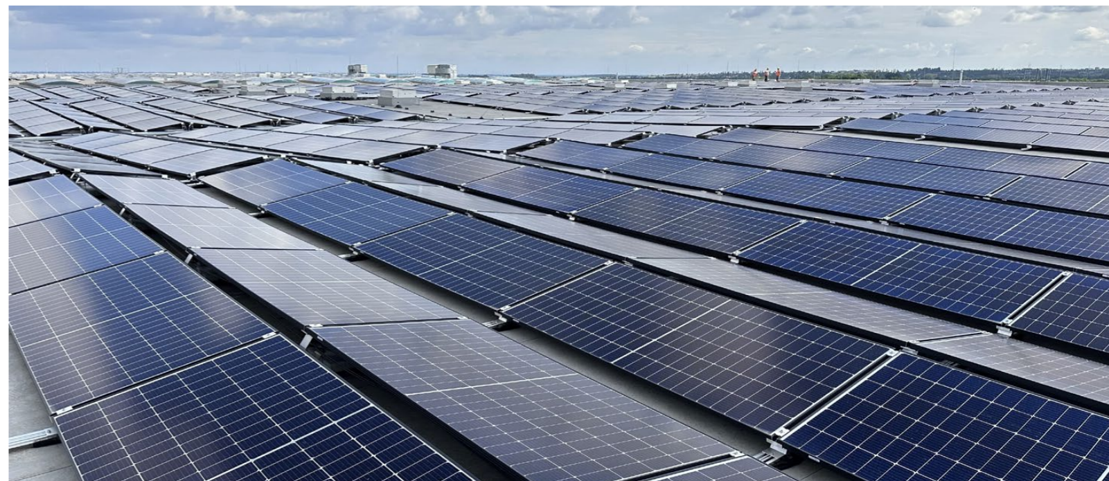
Mezi zákazníky ČEZ ESCO roste i zájem o velké firemní střešní fotovoltaiky. Jedna z největších je na střeše CTPark Prague East. Zdroj: ČEZ
